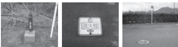
地上式消火栓
