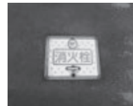
▲地下式消火栓
