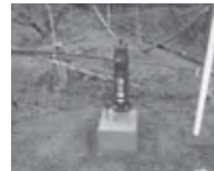
▲地上式消火栓
