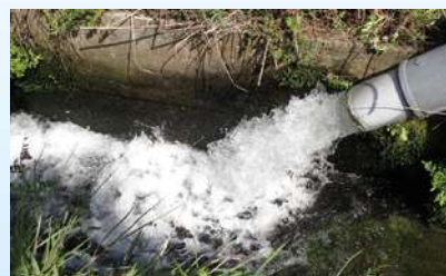
処理水の河川への放流状況
