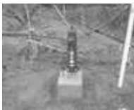
▲地上式消火栓
