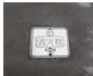
▲地下式消火栓
