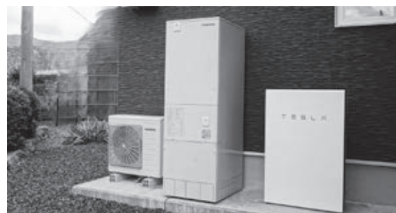
蓄電池設備導入事例
