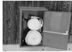
新調された格納庫、ホース
