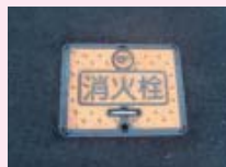
地下式消火栓
