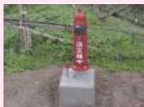
地上式消火栓
