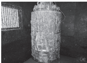
▲老朽化した揚水ポンプ (上中土地改良区・杉山第2揚水機場)
