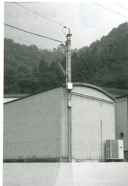
外灯などがついている自営柱の例
