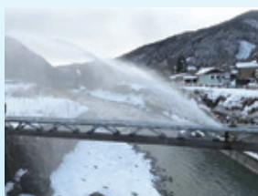
綿谷橋の漏水状況
