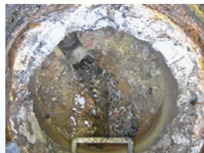
腐食したマンホールの状況
