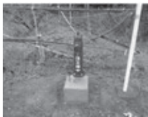
地上式消火栓
