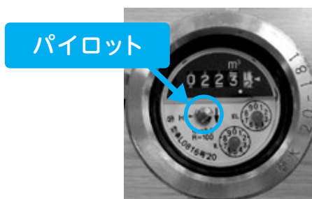
水道メーター
