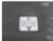
地下式消火栓
