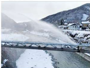
綿谷橋水管橋の漏水状況
