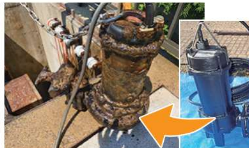
下水道ポンプ 劣化状況 (マンホールポンプ・各処理場)
