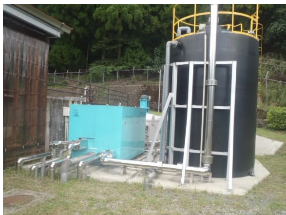
仮設ろ過装置（H29 設置）
