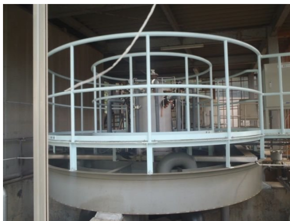
急速ろ過設備（H30～31 修繕）
